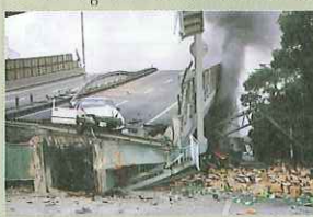
▲落橋した阪神高速道路(神社前)
