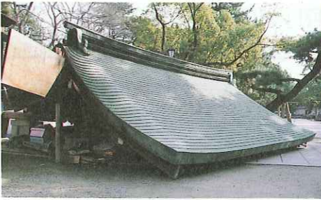
▲⑤ 屋根が落下した手水舎、テントを設け仮復旧。
