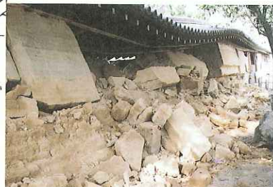
▲⑥ 国指定の重要文化財「大練塀」全長247mの築地塀で室町時代の構築。東面は練土が崩落、屋根が宙吊りとなっている。南面は屋根が西側に移動。西面も大破。
